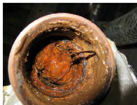
写真:さびコブの発生状況
