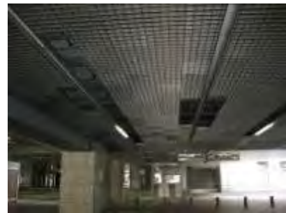
写真：天井材落下状況（11号街路下）
