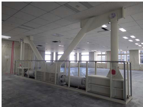
〈制振装置（オイルダンパー）〉
