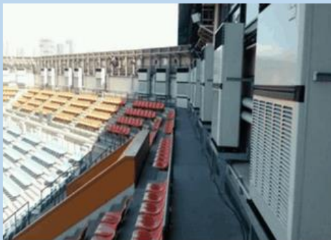
< 有明コロシアムの空調機（移設前） >
