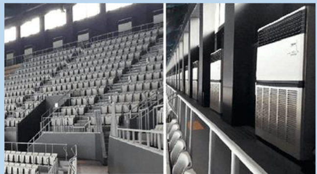
< 仮設観客席用空調機（移設後） >
