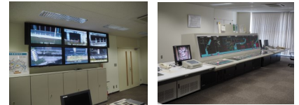
＜コントロールルーム＞
