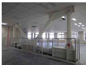
<都庁舎の制振装置>
