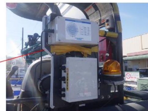
緊急停止補助装置
