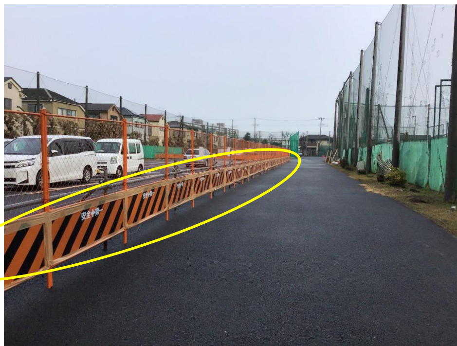
【B型バリケード隙間にガムテープを貼付】
