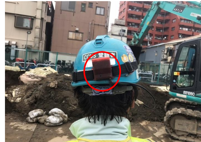
センサー設置状況
