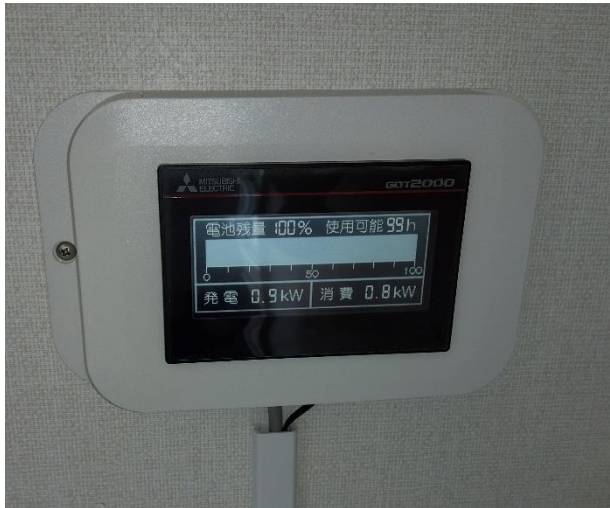
発電量と電気使用量がわかるモニター
