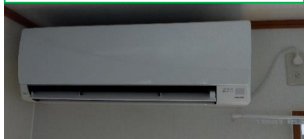
ソーラー電力でエアコンを稼働
