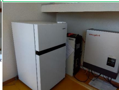
ソーラー電力で冷蔵庫を稼働
