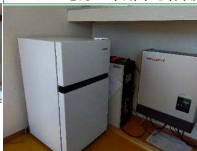
ソーラー電力で冷蔵庫を稼働
