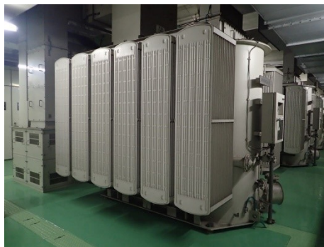
整流器用変圧器
