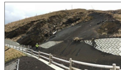
土砂流出状況
