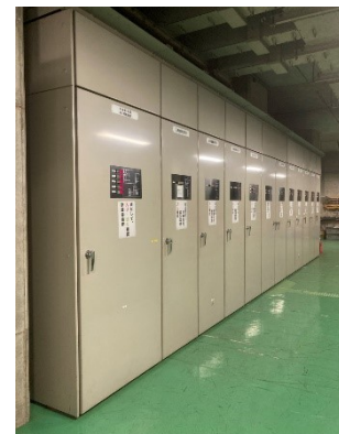
特別高圧 閉鎖配電盤
