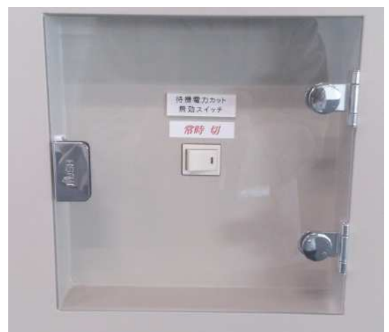
写真 11.2 待機電力カット系統制御スイッチ
