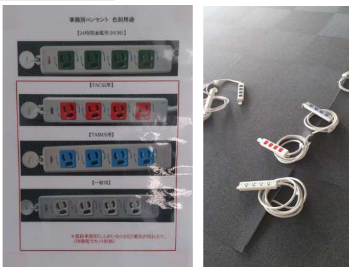
写真 11.1 待機電力カット系統コンセントの色分け(設置事例)
