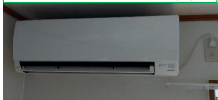
ソーラー電力でエアコンを稼働
