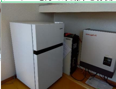
ソーラー電力で冷蔵庫を稼働
