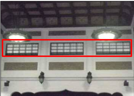
繊維強化プラスチックブロック製耐震壁（赤枠部）
