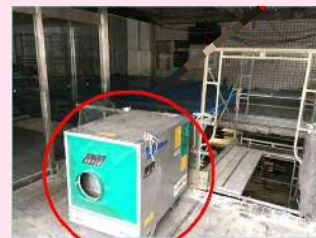
集塵機を設置し室内の換気を実施
