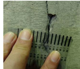
図 5_貫通ひび割れ 1.2mm
