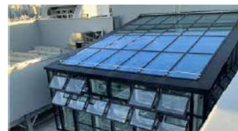
写真 エコボイド頂部(外観)
