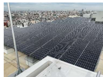
写真 屋上太陽光パネル
