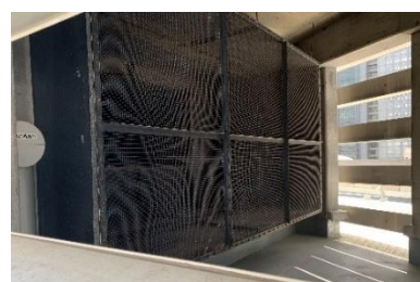
図 17 屋上空調室内給気口
