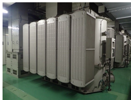
整流器用変圧器
