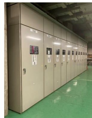
特別高圧 閉鎖配電盤
