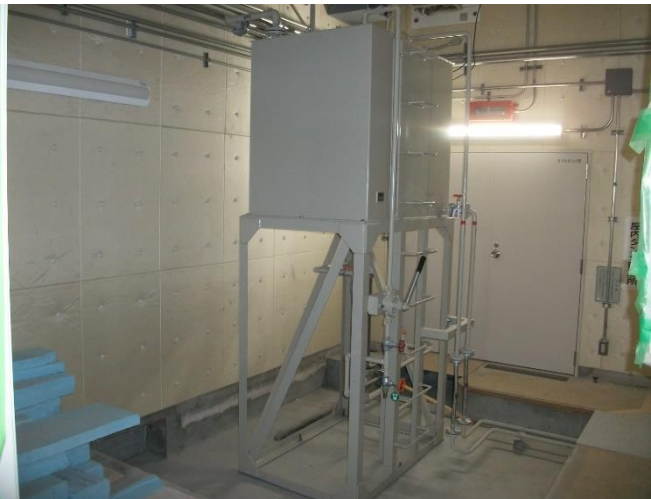
9500燃料小出し槽
